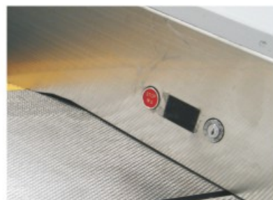
故障显示器 Fault display
